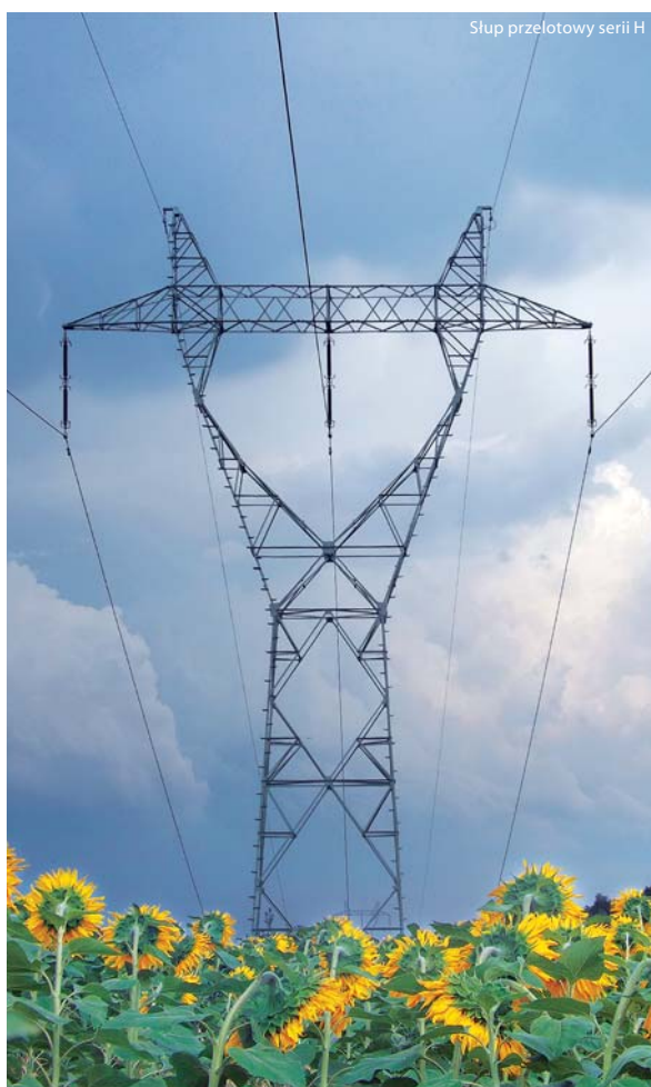
Linia elektroenergetyczna 220 kV relacji Joachimów – Rogowiec 2
