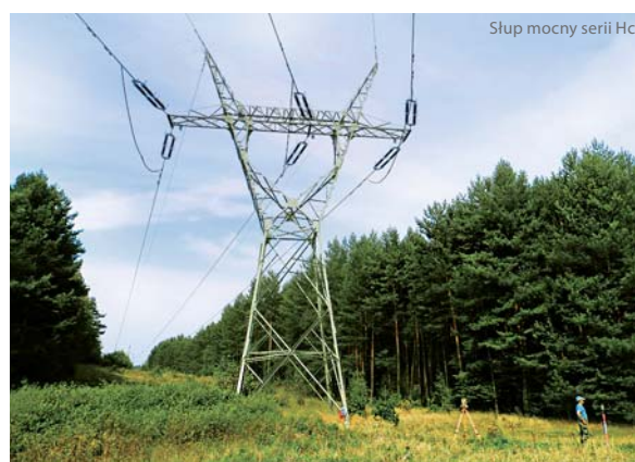
Linia elektroenergetyczna 220 kV relacji Łońskie – Kielce
